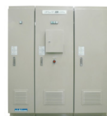
蓄電システム
